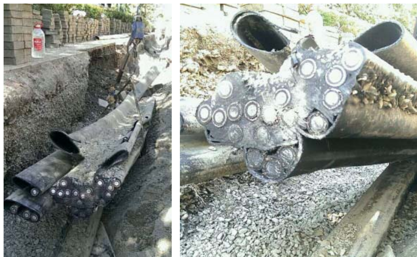
Рис. 1. Последствия халатного отношения к прокладке кабелей в трубах
