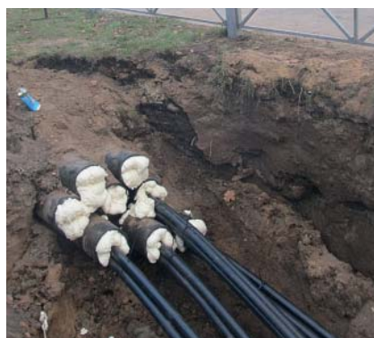
Рис. 4. Неокрашенная труба из обычного полиэтилена. Не имеет внутреннего НГ-слоя и уплотнителей (вместо них пена). Решение предназначено для КЛ до 1 кВ
