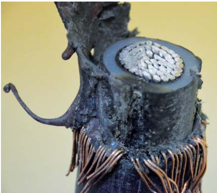
Рис. Кабель 10 кВ после удаления с него частей повреждённой муфты
