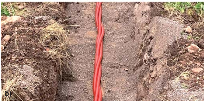
Рис. 6. Прокладка однофазных кабелей сомкнутым треугольником: а) скрепление кабелей хомутами; б) сплетение кабелей
