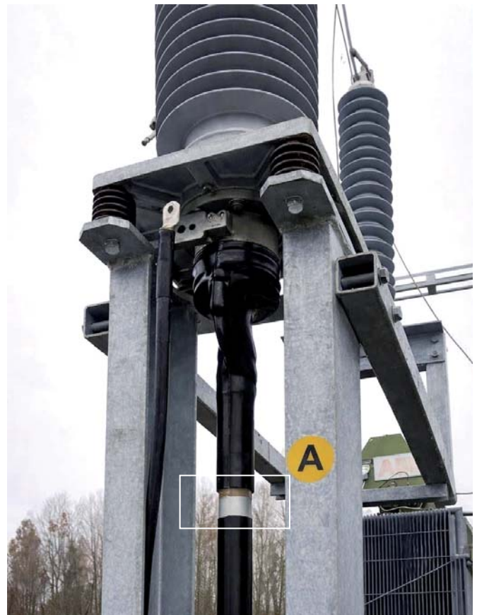
Рис. 2. Видимый разрыв ПП-слоя на оболочке кабеля
