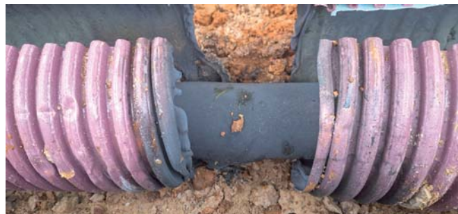
Рис. 7. Последствия точечного контакта ПП-слоя кабеля КЛ 132 кВ с землей на стыке труб
