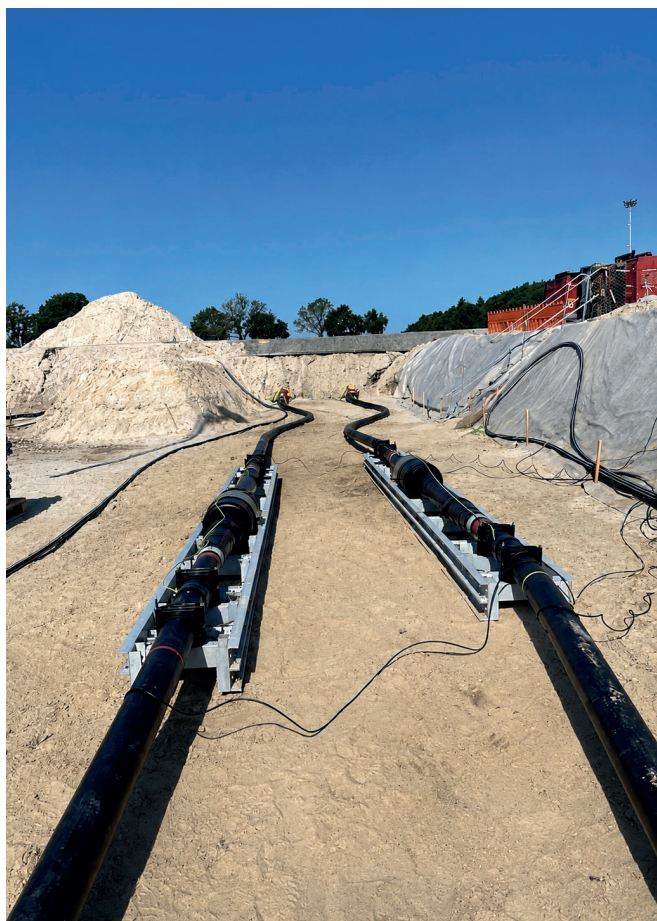
Рис. 7. Биполярная HVDC с муфтами на ложементах
